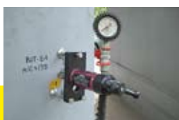
Натурные испытания на объекте (шпилька M10x135, установка в колонну из тяжелого бетона, максимальная нагрузка на вырыв 30,7 кН)
