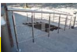
Крепление перил из нержавеющей стали (минимальное расстояние от края, не вызывает растрескивания декоративного камня)
